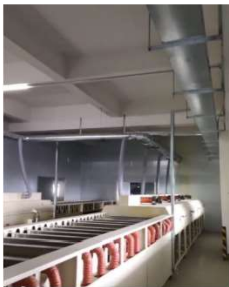
印刷車間及廢氣收集管道
