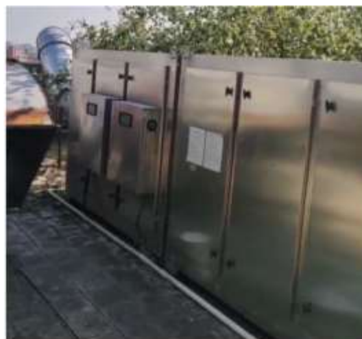
紫外線光解及活性炭吸附設備
